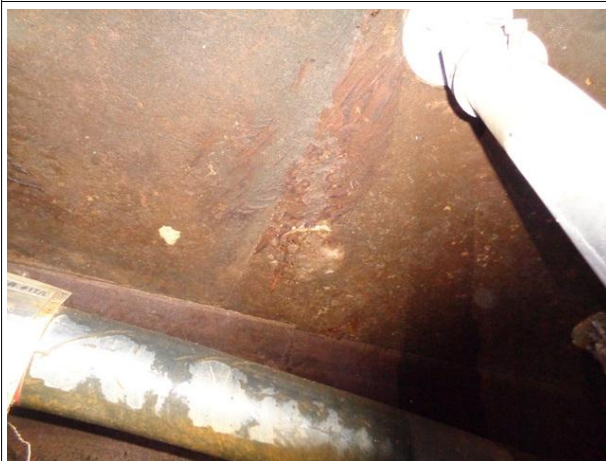
슬래브 재료분리 및 철근노출
