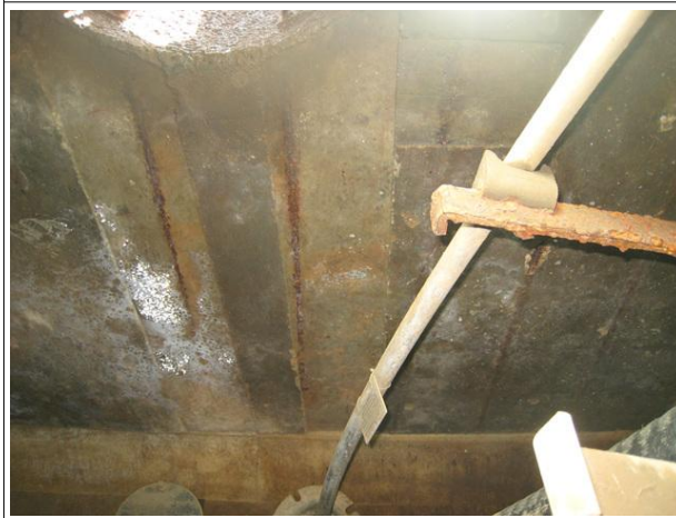
슬래브 박락 및 철근노출
