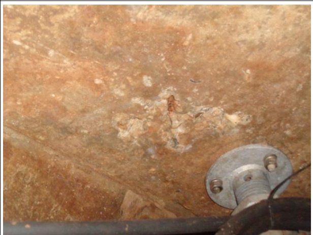
슬래브 재료분리 및 철근노출
