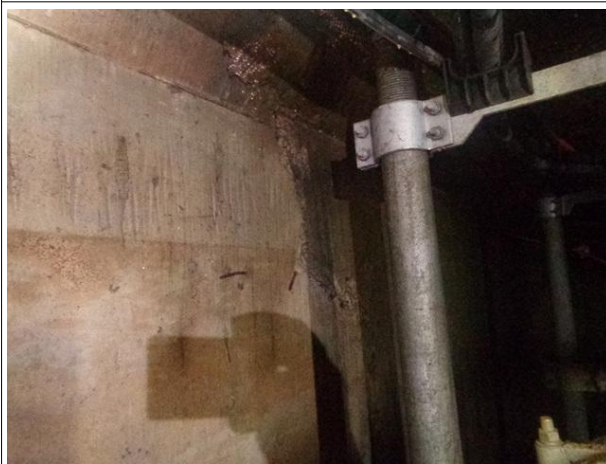
벽체 타설불량, 재료분리, 철근노출
