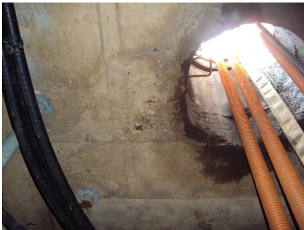
슬래브 재료분리 및 철근노출
