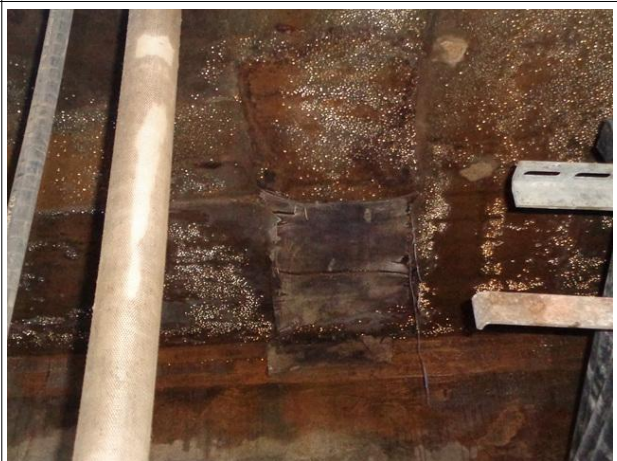
상부슬래브 거푸집 미제거
