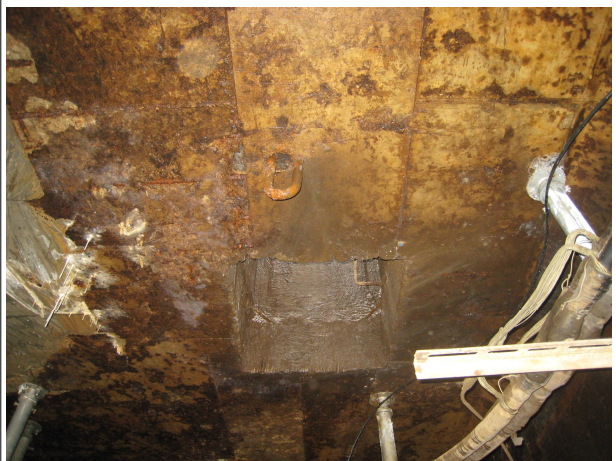
슬래브 박락 및 철근노출
