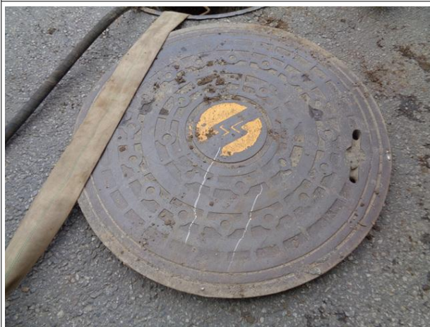
맨홀 뚜껑 균열
