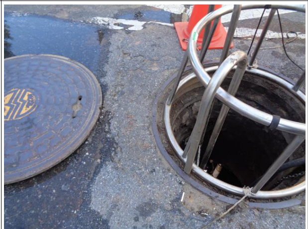
포장부 포장망상균열 및 파손
