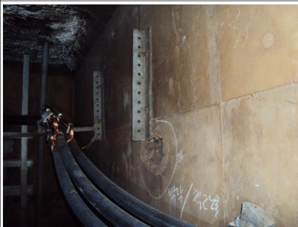
벽체 파손 및 철근노출
