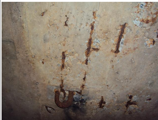
슬래브 재료분리 및 철근노출
