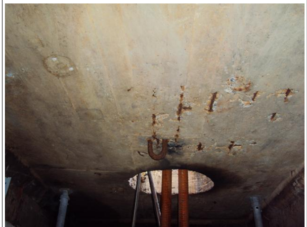
슬래브 재료분리 및 철근노출
