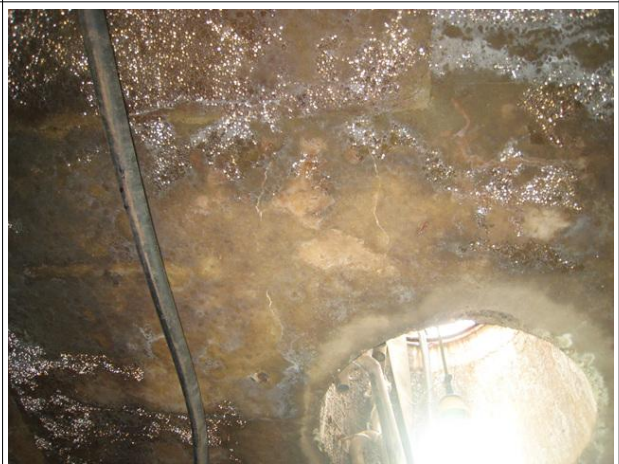
슬래브 균열부 백태
