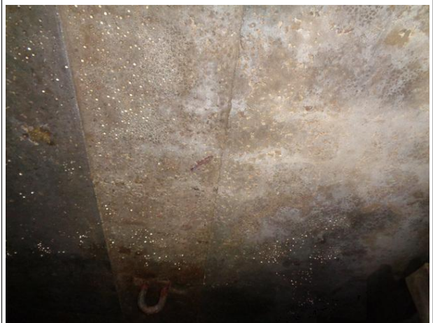
슬래브 재료분리 및 철근노출
