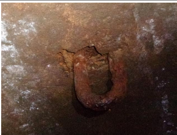
슬래브 파손 및 철근노출
