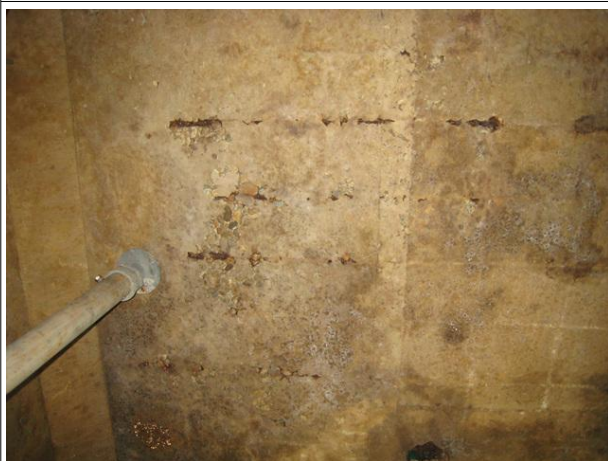
슬래브 재료분리 및 철근노출
