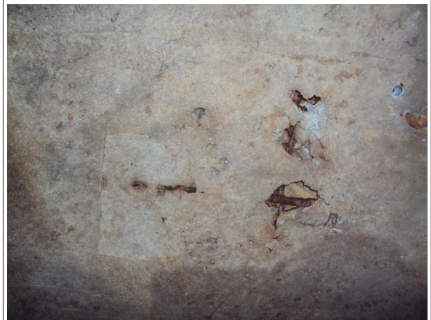
슬래브 재료분리 및 철근노출
