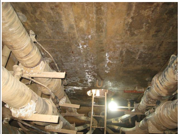
슬래브 재료분리 및 철근노출
