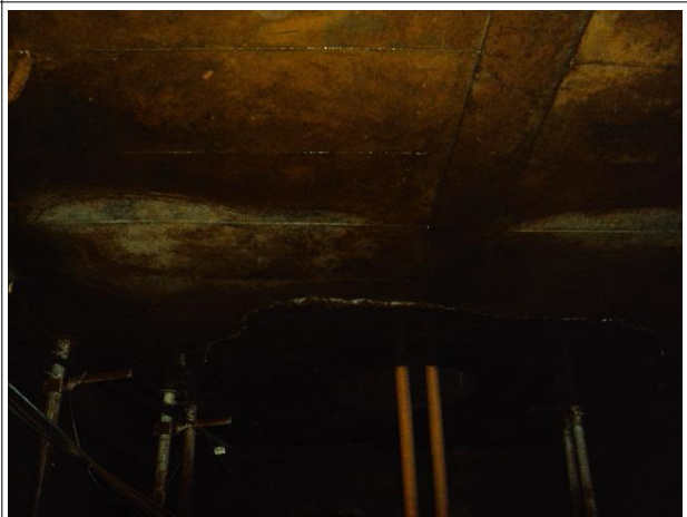
슬래브 들뜸 및 박락
