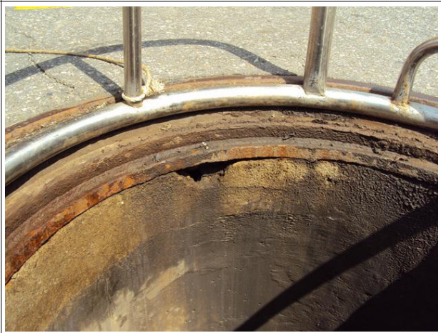
높이조정부 충전재 파손
