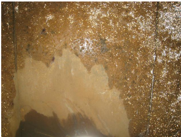
슬래브 균열부 백태
