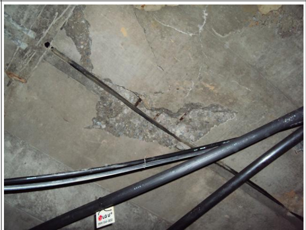
슬래브 박락 및 철근노출
