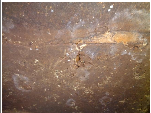
슬래브 재료분리 및 철근노출
