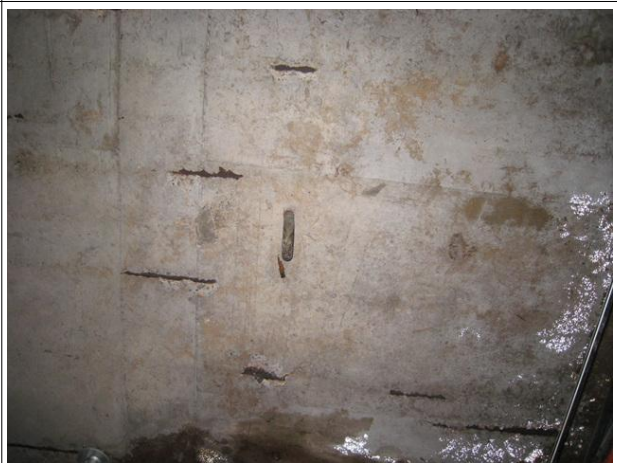
슬래브 재료분리 및 철근노출
