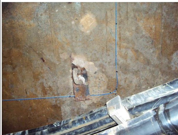
슬래브 파손 및 철근노출
