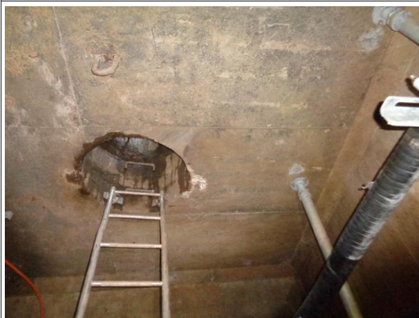
상부슬래브 파손 및 백태
