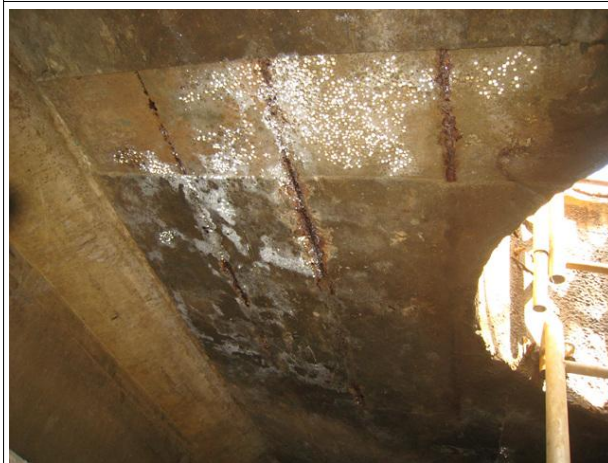
슬래브 박락 및 철근노출
