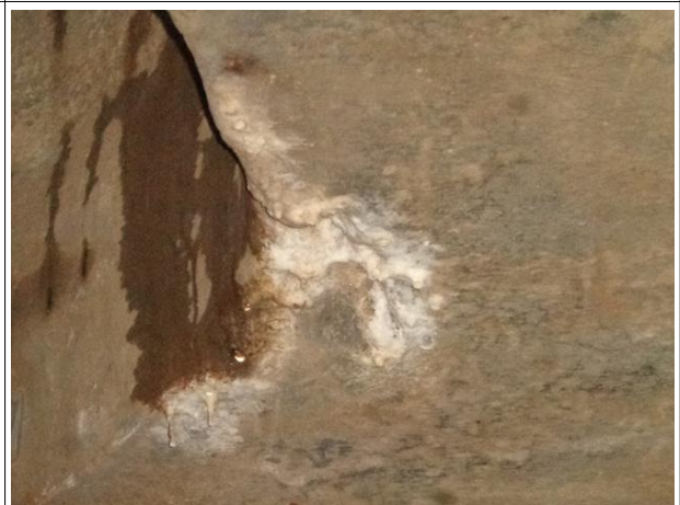
상부슬래브 파손 및 백태
