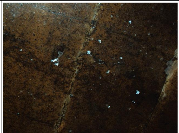
슬래브 균열부 백태
