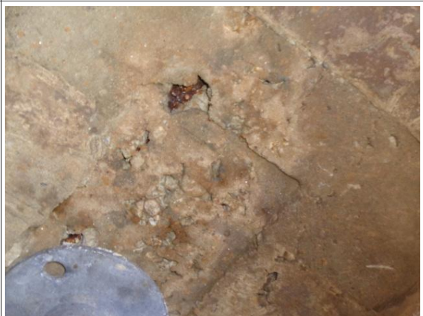
슬래브 공동 및 철근노출, 타설불량
