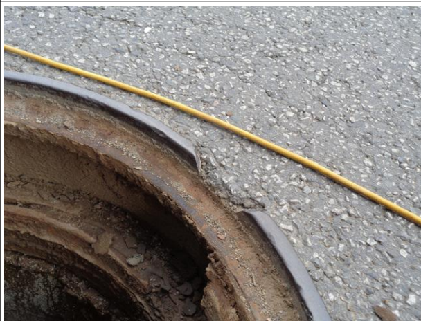
맨홀 틀 파손
