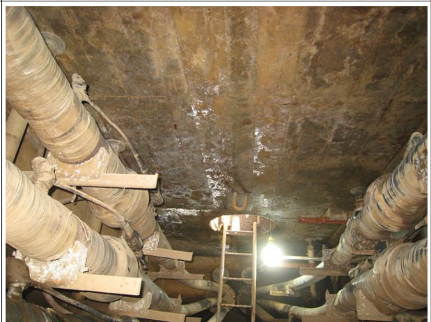
슬래브 박락 및 철근노출
