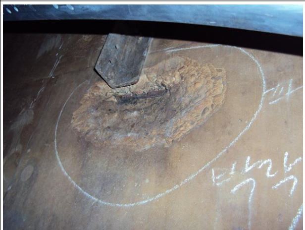
벽체 파손 및 철근노출
