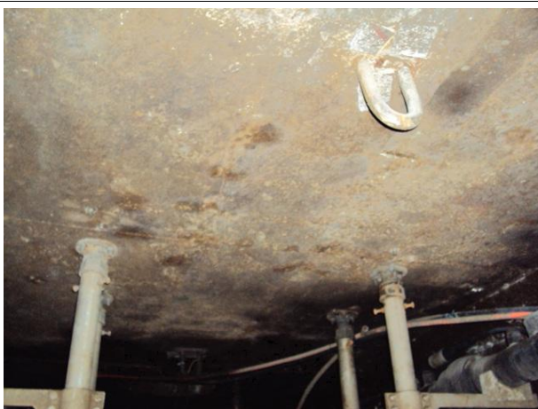
슬래브 재료분리 및 철근노출
