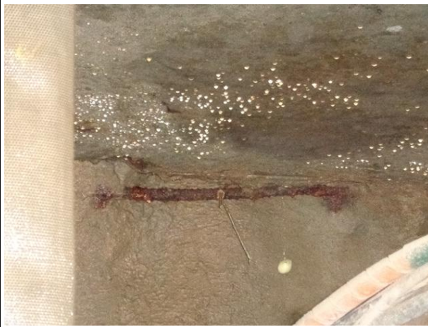
슬래브 박락 및 철근노출
