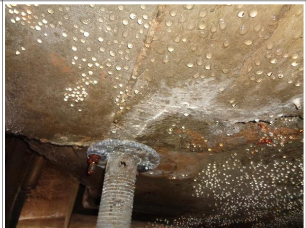
슬래브 균열부 백태
