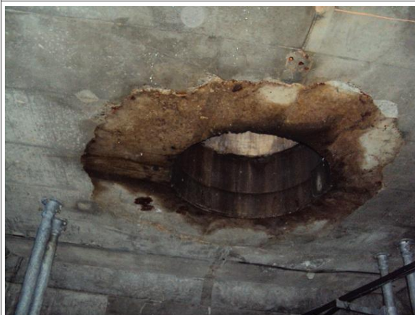
슬래브 들뜸 및 박락
