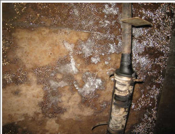
슬래브 균열부 백태
