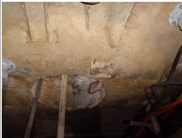
슬래브 거푸집 미제거
