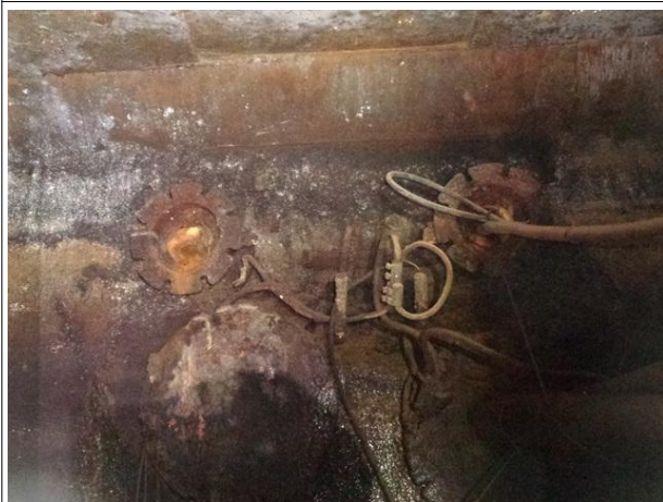
관로부 파손 및 철근노출
