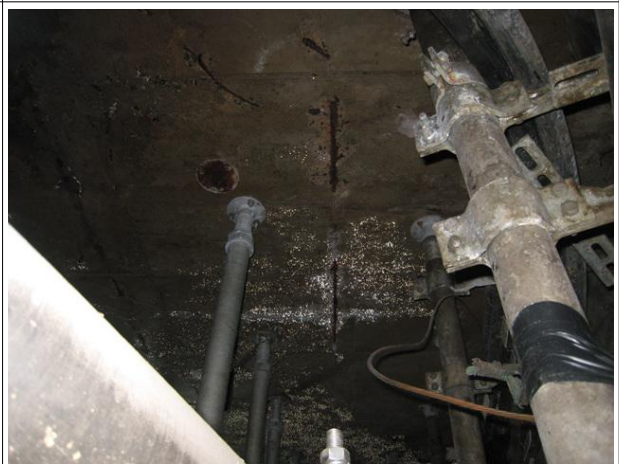
슬래브 박락 및 철근노출
