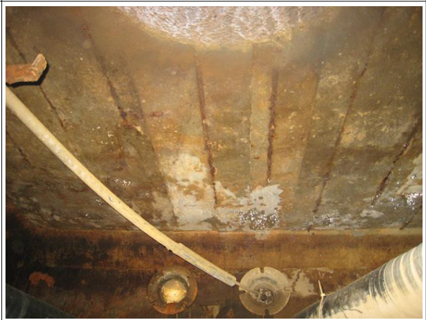
슬래브 박락 및 철근노출
