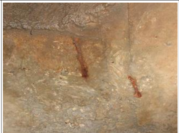
슬래브 재료분리 및 철근노출
