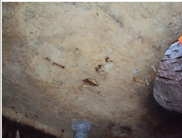
슬래브 재료분리 및 철근노출
