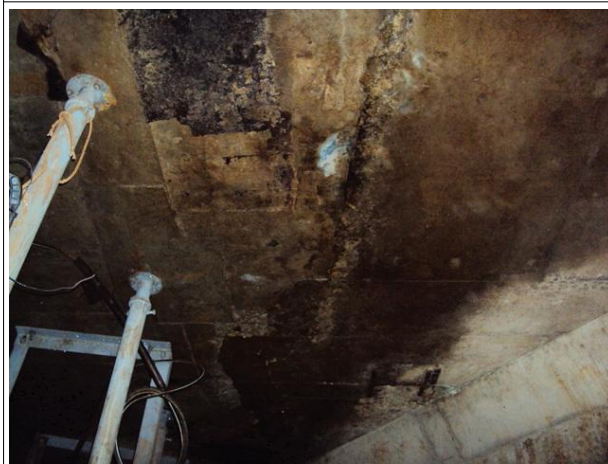
슬래브 박락 및 철근노출
