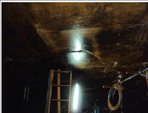
슬래브 들뜸 및 박락
