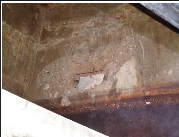
벽체 콘크리트 파손 및 철근노출
