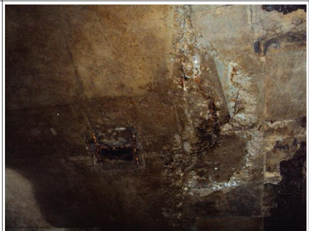
슬래브 박락 및 철근노출
