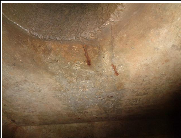
슬래브 재료분리 및 철근노출
