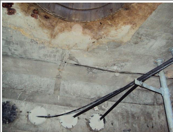
슬래브 박락 및 철근노출
