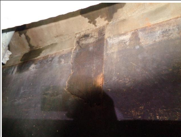
상부슬래브 거푸집 미제거
