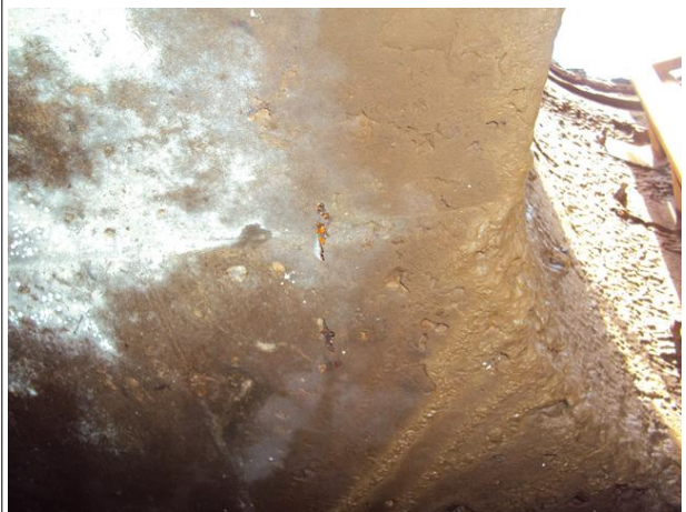
슬래브 재료분리 및 철근노출
