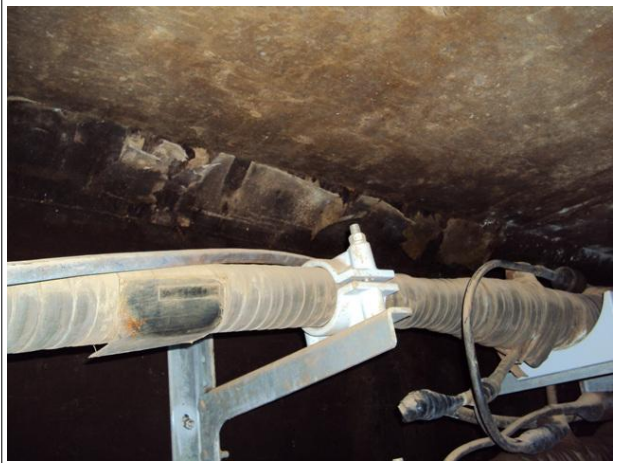
슬래브 거푸집 미제거
