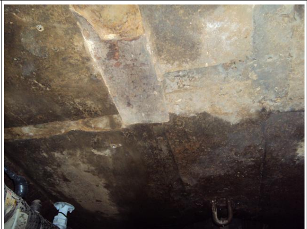
슬래브 재료분리 및 철근노출
