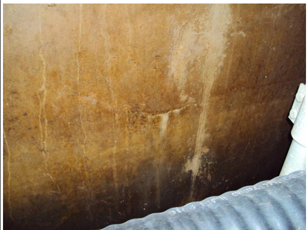
벽체 균열부 백태
