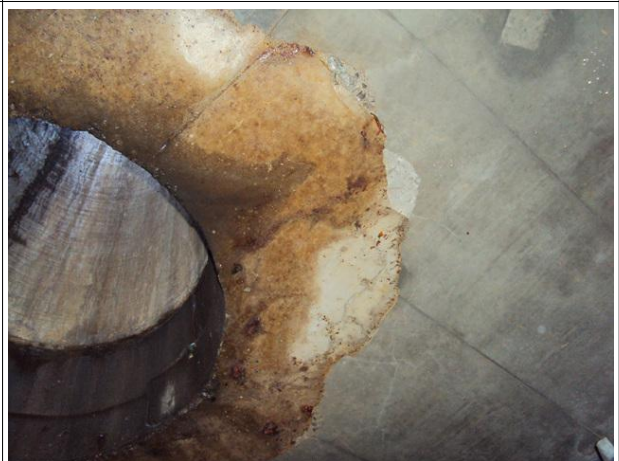
슬래브 들뜸 및 박락
