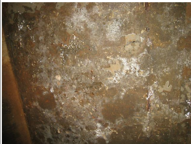
슬래브 재료분리 및 철근노출
