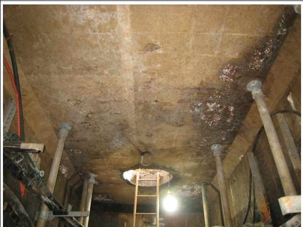
슬래브 재료분리 및 철근노출
