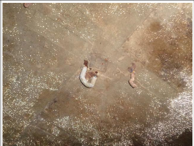
슬래브 공동 및 철근노출
