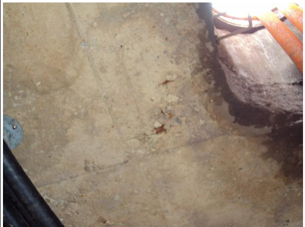
슬래브 재료분리 및 철근노출
