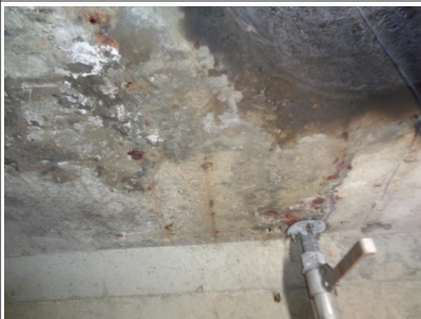
슬래브 박락 및 철근노출
