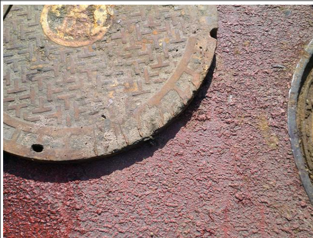
포장부 맨홀뚜껑 파손
