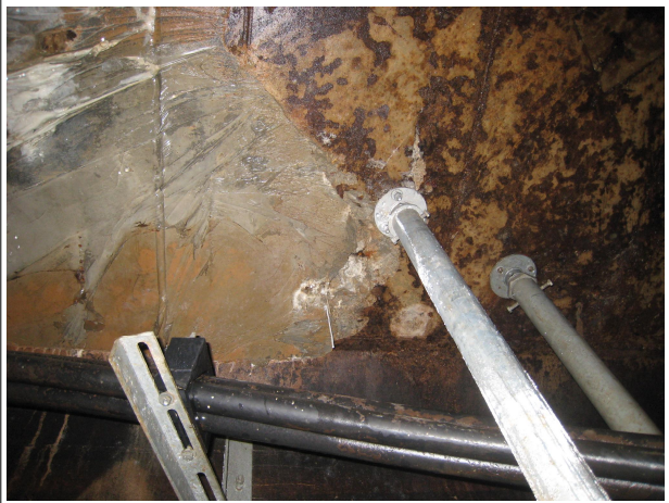
슬래브 균열부 백태
