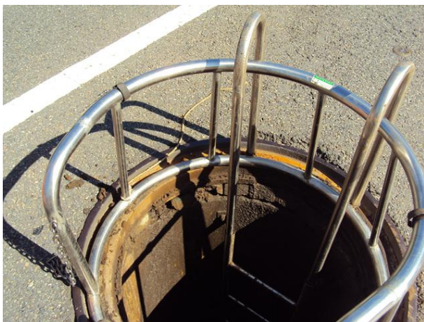
포장부 높이조절부 파손
